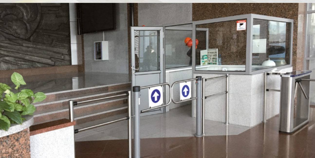
Калитки WHD-05, ГЭС, Красноярск
