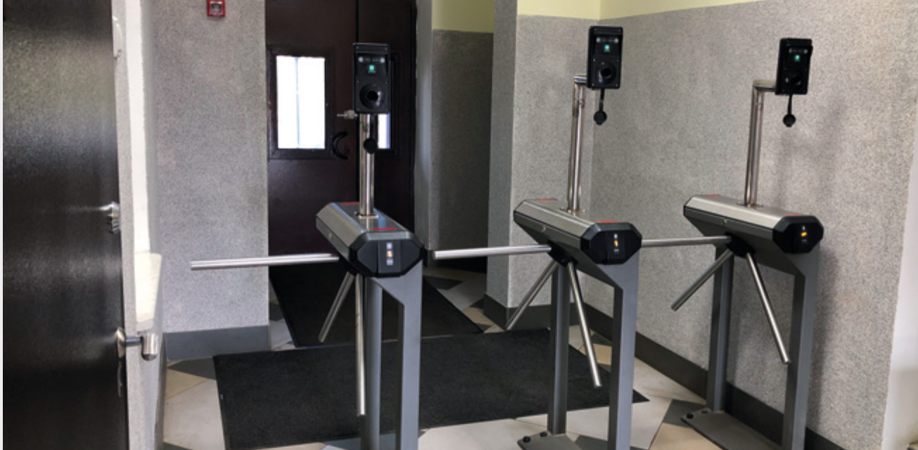
Электронные проходные КТ02 с алкотестерами, ЗАО «НПО Специальных материалов», Санкт-Петербург
